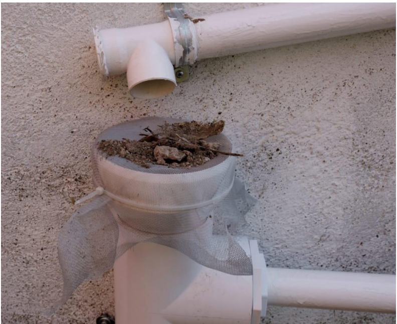
Filtro de hojas en la entrada de un primer separador de PVC (sin limpiar)
