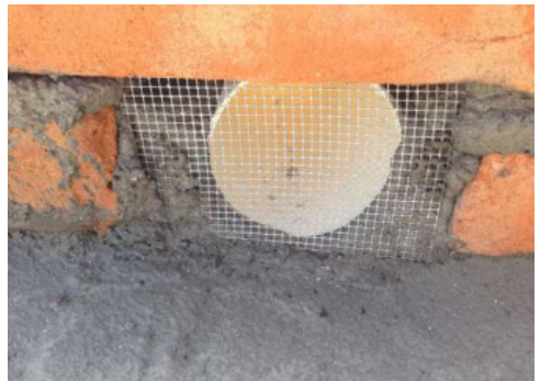
Filtro de hojas instalado en la salida del techo al sistema de tuberías
