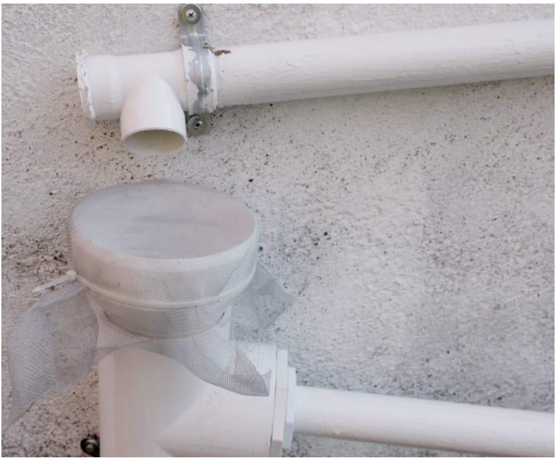
Filtro de hojas en la entrada de un primer separador de PVC (limpio)
